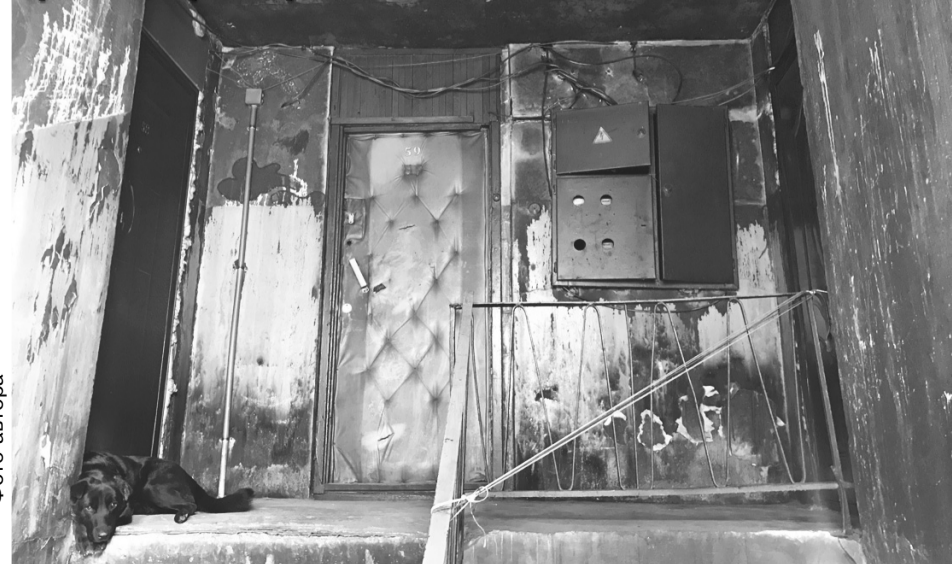
19-й километр. После пожара в порядке ремонта привязали перила веревочкой
